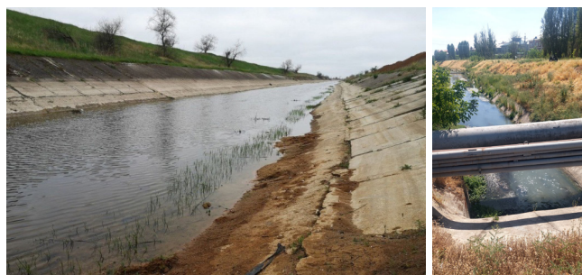
3-rasm. Kanallarning beton qoplamalaridagi asosiy texnik nuqsonlar:
